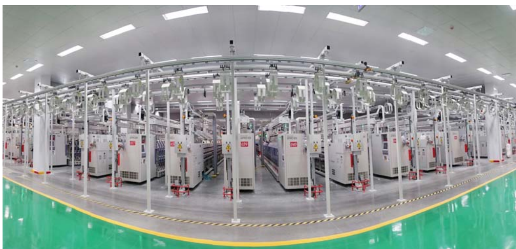
魏桥纺织绿色智能纺织一体化项目生产车间
